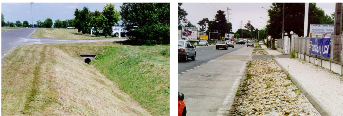
Figura 6.2 – Técnicas compensatórias de drenagem urbana em Bordeaux/França: (a) vala de retenção e infiltração e (b) trincheira de infiltração. (Foto: Márcio Baptista, 1999)
